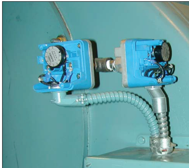
Figura 2-3. Interruptor de alta presión de aire e interruptor de prueba de aire de combustión
